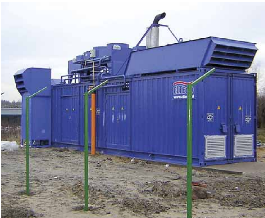
Instalacja odgazowania odpadów na składowisku w Urbanowicach
